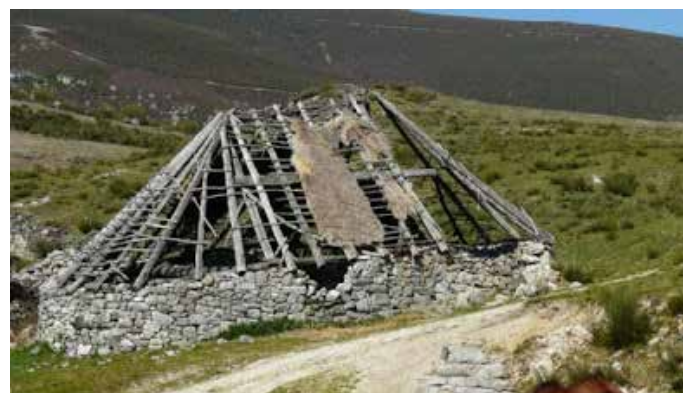
Palloza en ruinas, 2014. Campo del Agua (Foto de Santiago Casteao).
