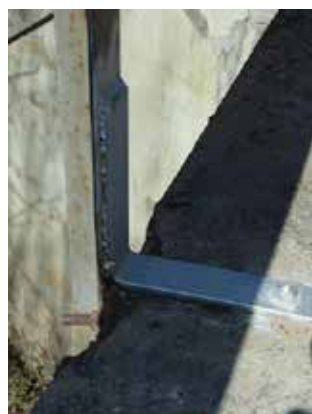
Tornillos que sobresalen del firme.
